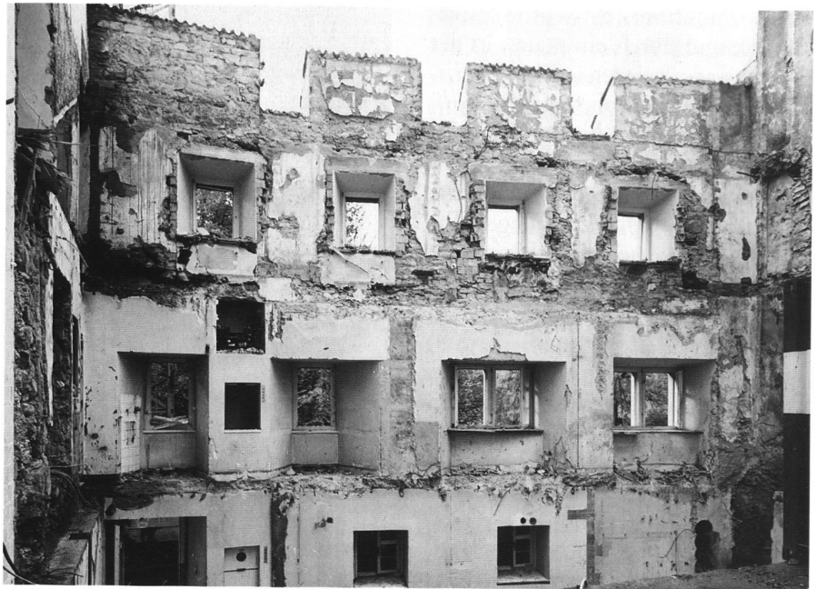
40: Nordansicht an die mittelalterliche Schildmauer, später mehrfach erhöht und 1972 durch Fenstereinbauten stark durchbrochen; rechts der ummauerte Palas von 1451 mit Türausgang zu einem zeitweiligen Wehrgang.
